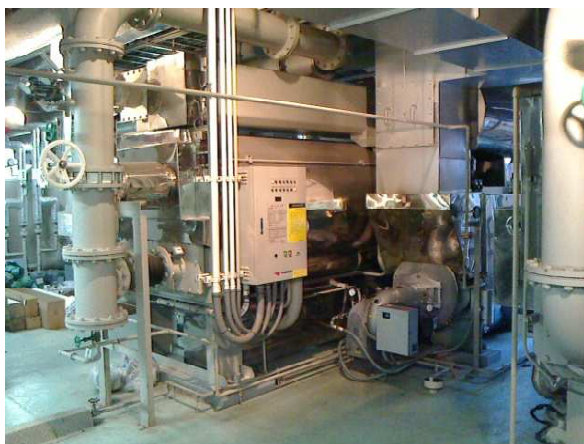
(冷温水発生機)
